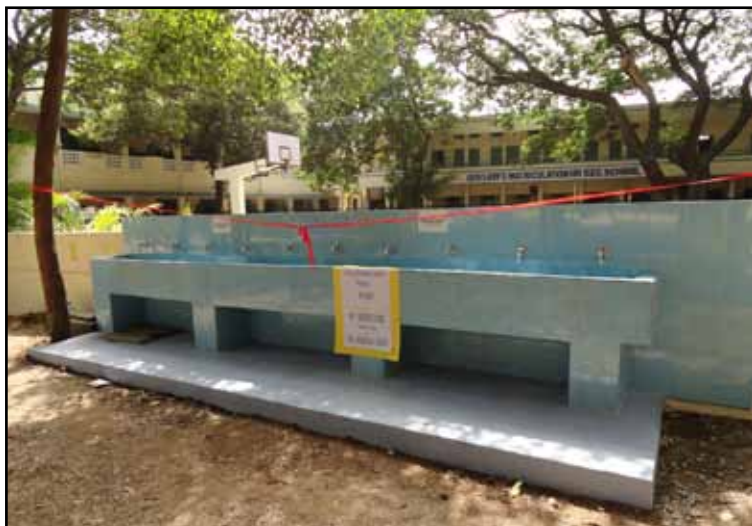
Vannrenseanlegg på Auxilium Primary School i Chennai, India.
